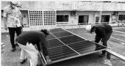
太陽光パネルの施工現場を見学する拓南・沖電Pメンバー
